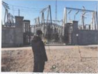
110kV 章盖营变电站东侧大门
