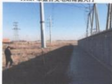
110kV 章盖营变电站北侧
