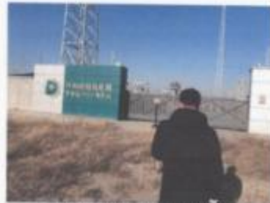
110kV 章盖营变电站南侧大门
