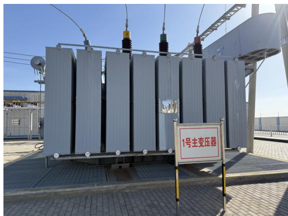
查汗苏立德 110kV 变电站 1#主变
