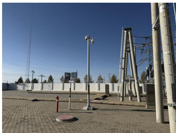
陶利 110kV 变电站事故油池
