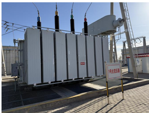
陶利 110kV 变电站 1#主变
