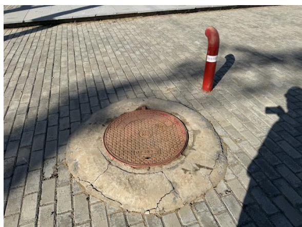
查汗苏立德 110kV 变电站事故油池
