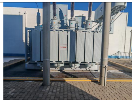
罕台变1号主变
