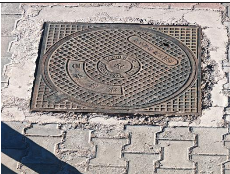
装备变化粪池
