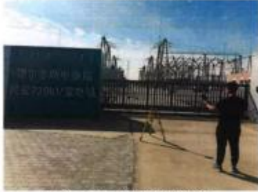
民安 220kV 变电站北侧大门
