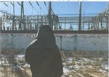
北侧东起第 7 间隔
