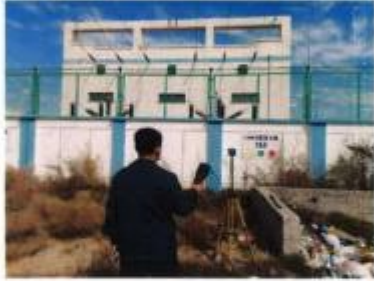
110kV 民贵 II 线进线处
