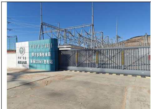
装备 220kV 变电站大门
