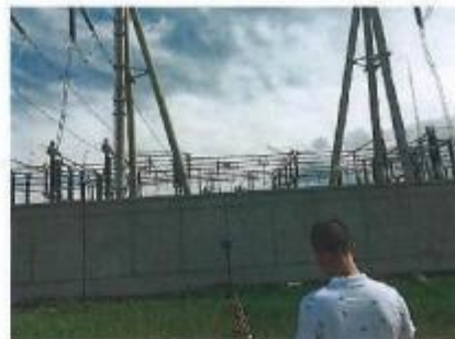
盐海 220kV 变北
