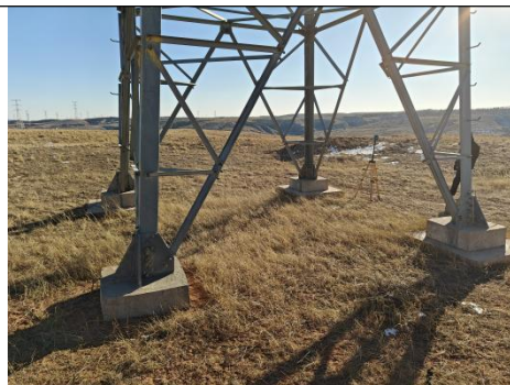
莲罕线 61 号塔下
