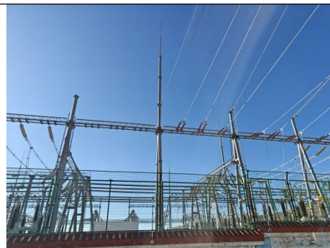
装备站出线间隔处
