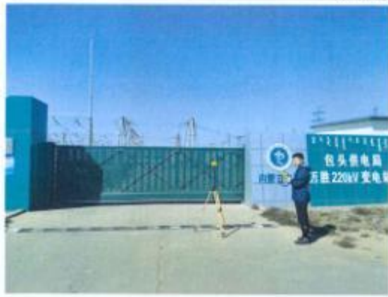
万胜变电站大门口电磁检测
